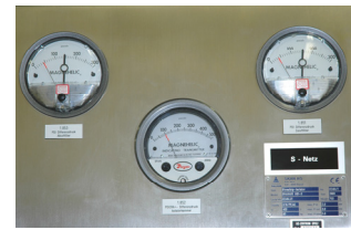
Die Anlage wird im Unterdruck betrieben und über Manometer überwacht.
